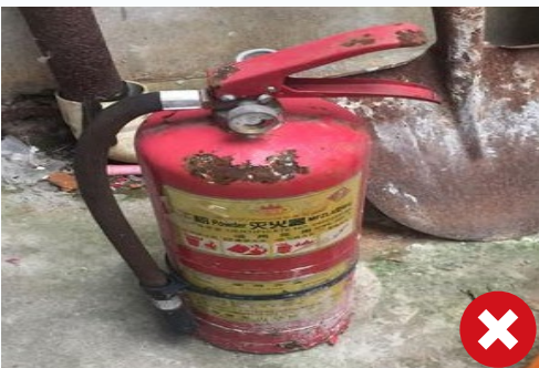
干粉灭火器锈蚀严重仍继续使用
