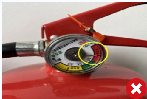
干粉灭火器压力不足
