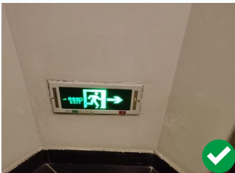
灯具直接与消防电源直接连接
