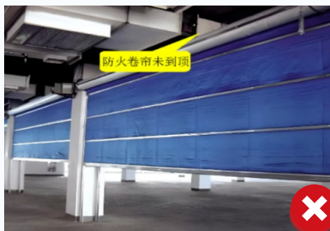
防火卷帘未到顶不能有效形成防火分隔
