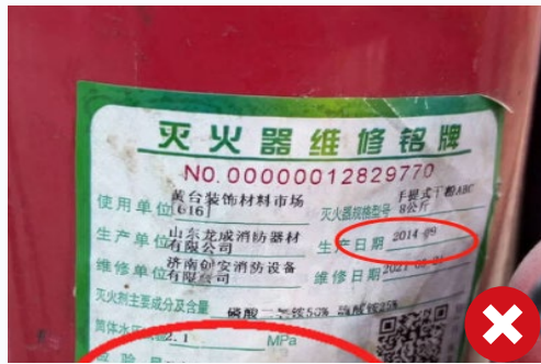
干粉灭火器超 10 年未报废仍继续使用
