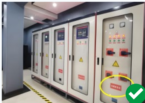
消防水泵控制柜标识清晰
