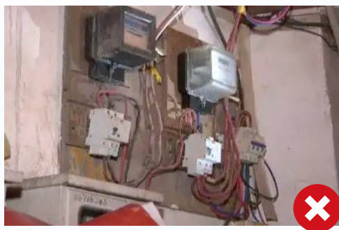
电气线路敷设在可燃材料上
