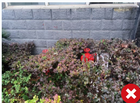
消防水泵接合器被圈占、遮挡
