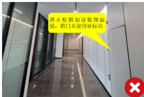
消火栓箱未做明显标识
