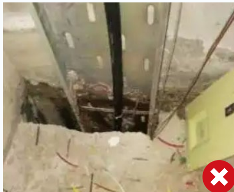
电缆井楼板处未进行防火封堵（破坏了竖向防火防烟分隔，烟火可沿破口向上蔓延）
