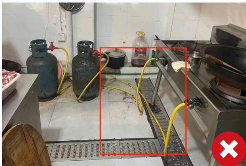
燃气软管长度超过 2m
