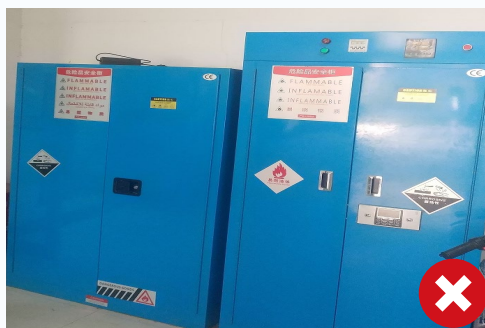
危险化学品储存柜无通风设施
