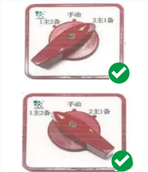
消防水泵控制柜处于自动状态
