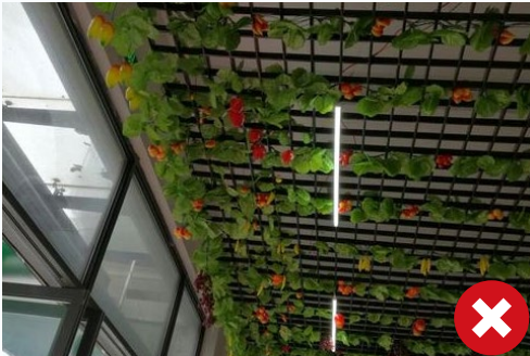
使用易燃可燃的塑料绿植装饰吊顶
