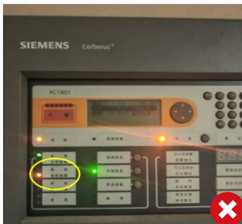
系统运行有备电故障未处理
