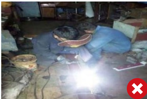
无人监护、未设灭火器及灭火器材
