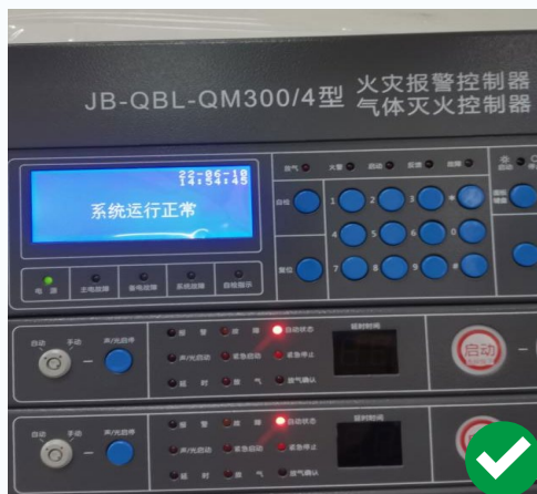
系统处于自动状态，运行正常
