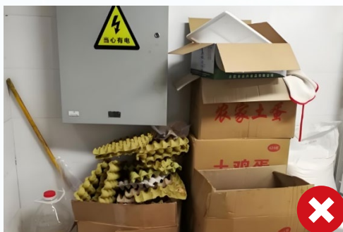
配电箱周围堆放杂物
