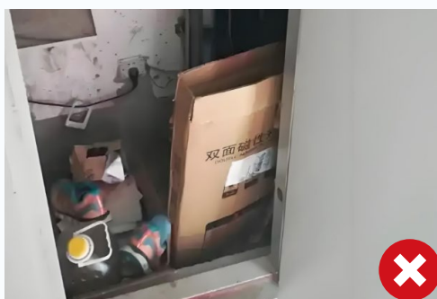
电缆井堆放可燃杂物
