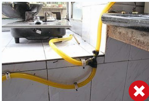
燃气软管私接三通
