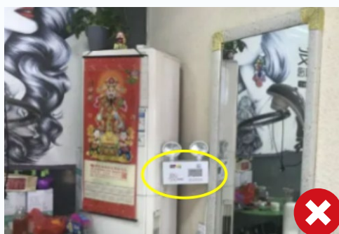
应急照明灯具未设置在墙面上部，影响照明效果
