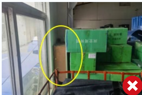
货物遮挡室内消火栓
