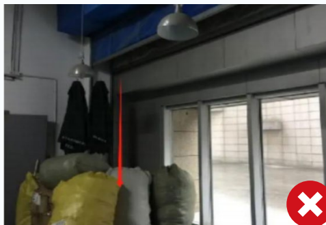
防火卷帘下方堆放杂物无法下降关闭
