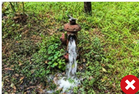
供水压力不足
