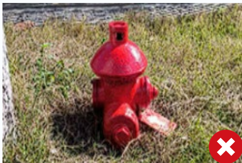
室外消火栓被埋压
