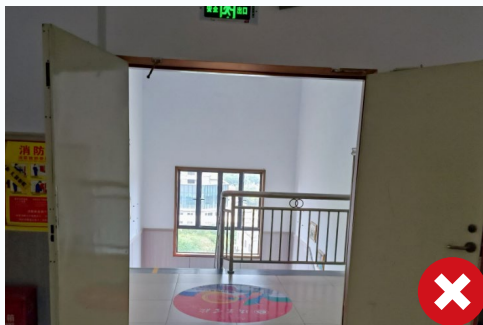
楼梯间的门未向疏散方向开启
