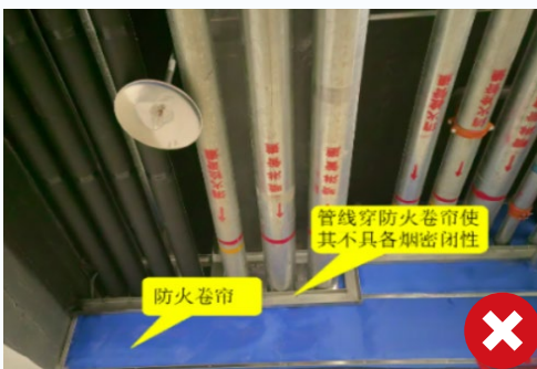
管线穿过防火卷帘破坏其密闭性
