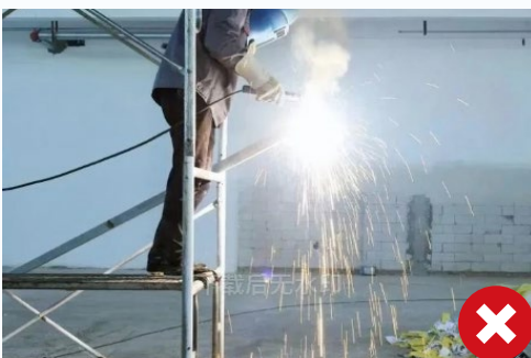
施工区域与使用区域未隔离
