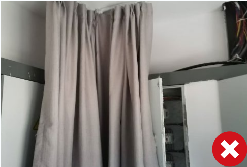
违规挪用配电室，并用可燃材料装饰遮挡配电箱
