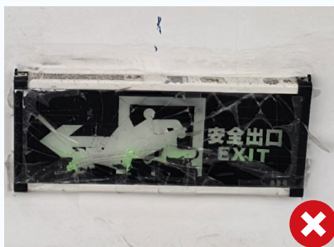
疏散指示标志损坏
