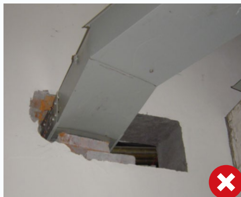
电缆桥架穿墙处未封堵（破坏了同一平面的防火防烟分隔，烟火可沿破口横向蔓延）
