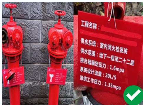
消防水泵接合器外观及其组件良好，有永久性标志铭牌
