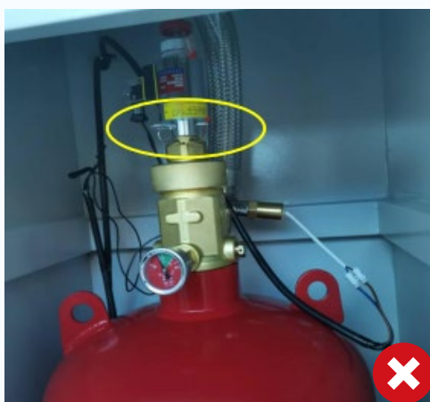
灭火剂储存容器的电磁开关下方插销未拔出
