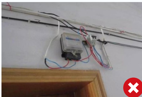
电气线路私拉乱接
