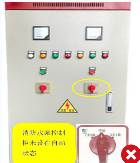
消防水泵控制柜未设在自动状态
