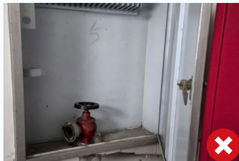
消火栓箱内缺少水带、水枪
