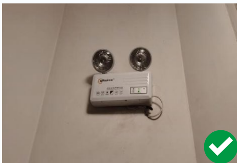
应急照明灯具表面应无污渍，确保设备的正常工作 和良好的发光效果
