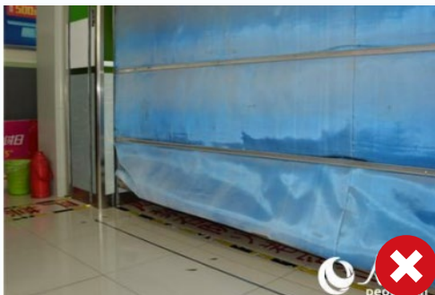
防火卷帘破损关闭不严
