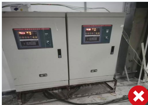
消防水泵控制柜未做标识
